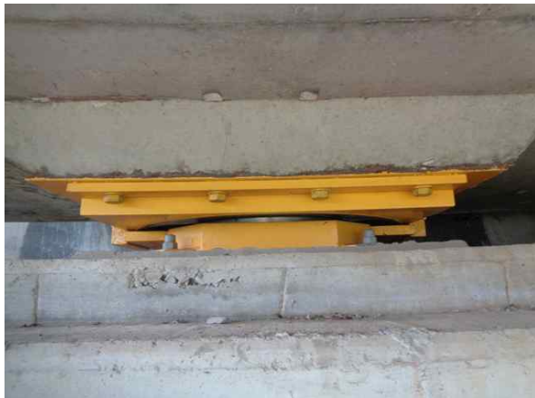
A2-Sh1 받침콘크리트 재료분리(0.6×0.2)
