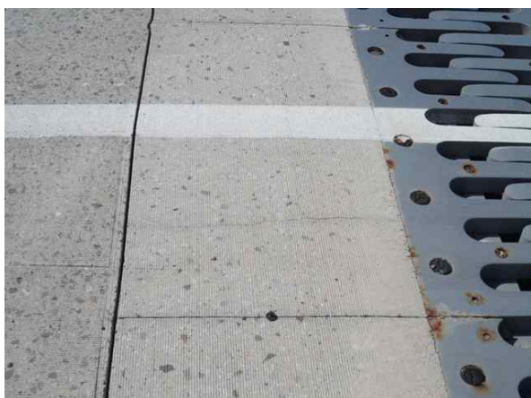
신축이음 A1 후타재 균열(Cw=0.3mm미만)
