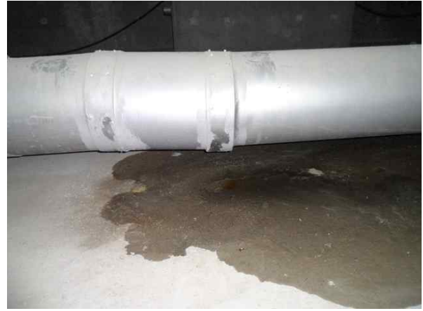
배수시설 S4 배수관 누수 1EA
