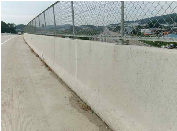
방호벽 S1 균열 (Cw=0.3mm미만)
