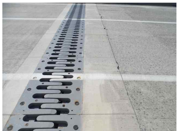
신축이음 A2 후타재 균열(Cw=0.3mm미만)
