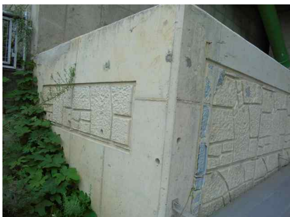
교대 A1 균열(Cw=0.3mm미만)
